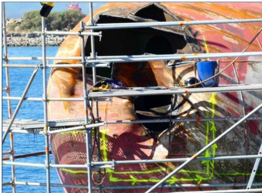
Figura 3: Daños en la proa del “ADAM LNG” en reparación
